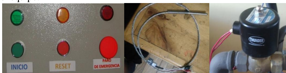
Figura 4-2 Pulsadores, luces piloto, pt100 y electroválvula
