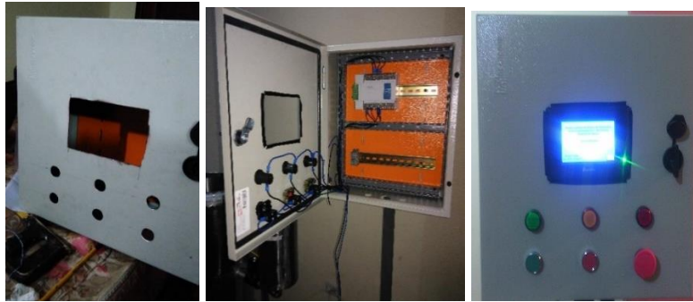
Figura 10-2 Gabinete eléctrico Fuente: Elaboración propia
